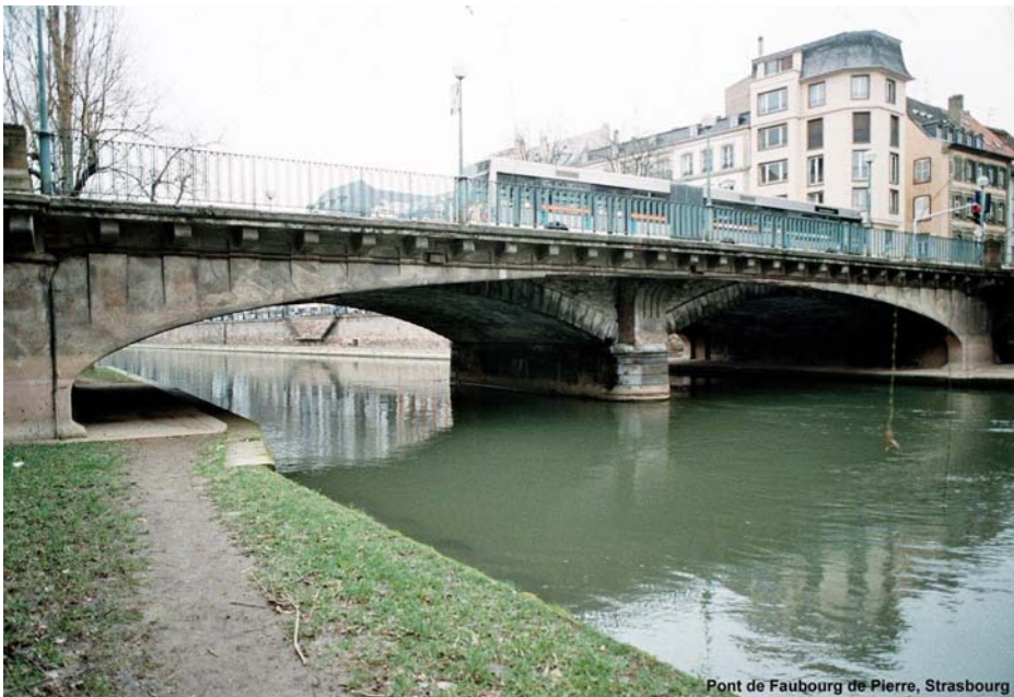
Ansicht der Brücke / Brückenschäden
